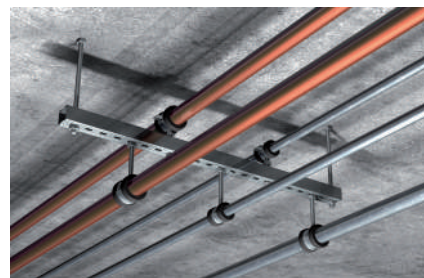
Instalacje sanitarne i przemysłowe
